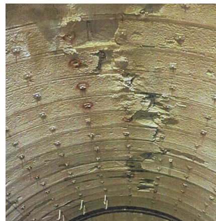
図2 トンネル支保工変状発生状況
