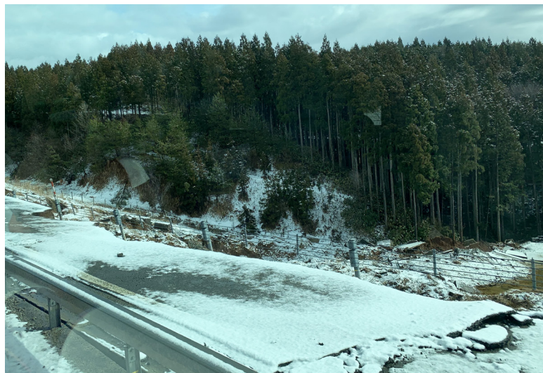
写真1 能登半島地震での道路被害例
