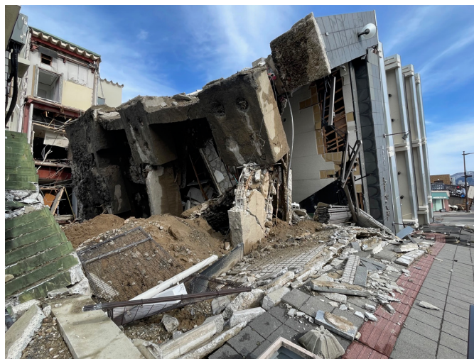
隆起した土地と転倒したビル(輪島市)
