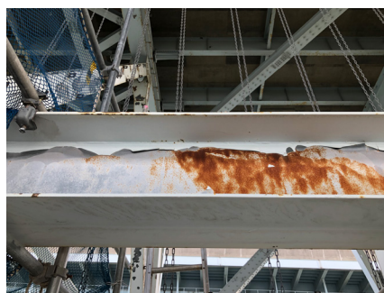
荒川湾岸橋の損傷状況
