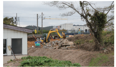
福島県本宮市北川原田地区の安達太良川堤防決壊箇所
